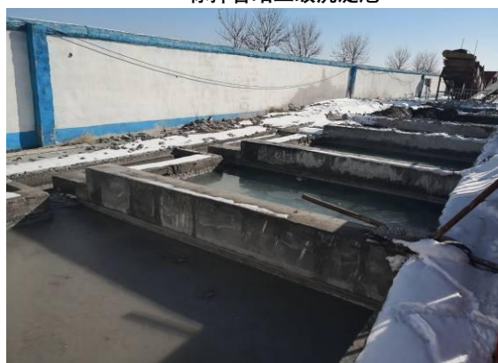
3 标 2#拌合站三级沉淀池
